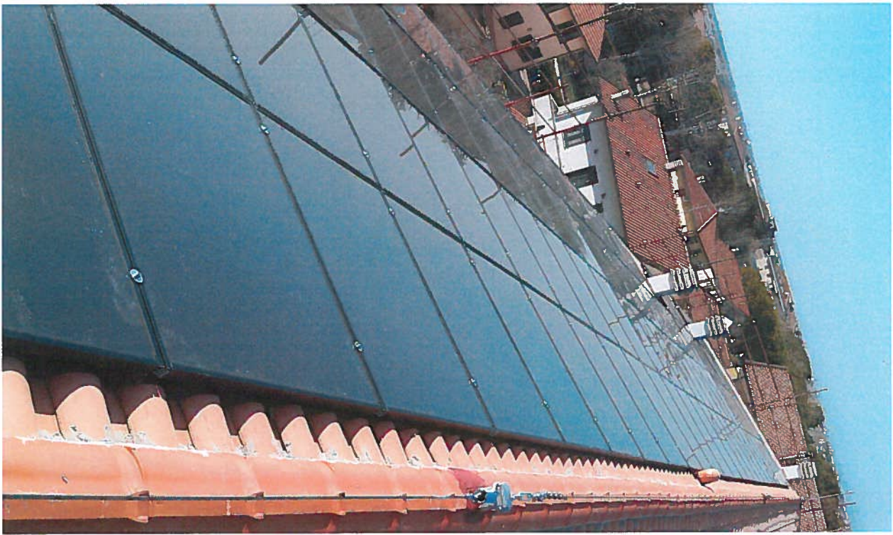
Fotografia 12: particolare impianto fotovoltaico
